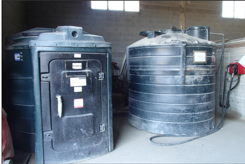
Figure 38 - Le stockage de GNR et GO dans des réservoirs double peau et poste de remplissage
