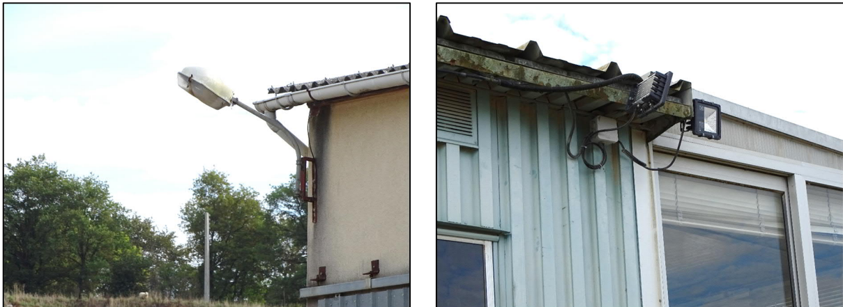
Figure 40 - Eclairage installé sur la carrière
